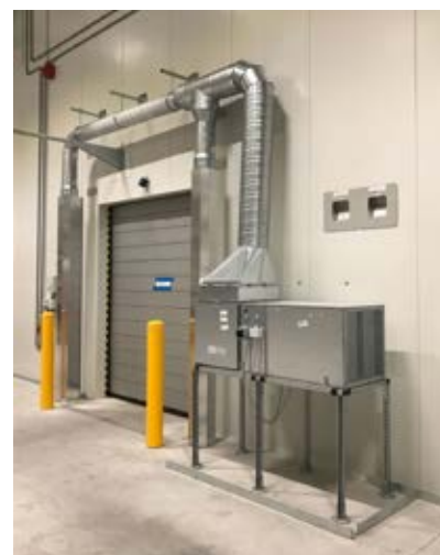
Luftwandanlage sind auch wie hier für eine Temperaturtrennung zwischen Kühlraum und normaltemperiertem Raum geeignet.
